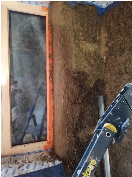
Figure 17: étanchéité autour d'une fenêtre. Photo : Guillaume Charrier
