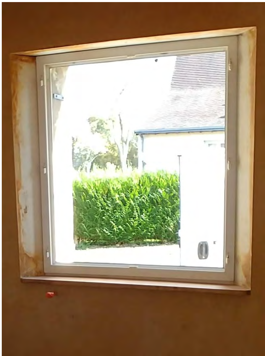
Figure 5: Plaque fermacell bloque le retour du frein vapeur / en attente de la finition enduite.
