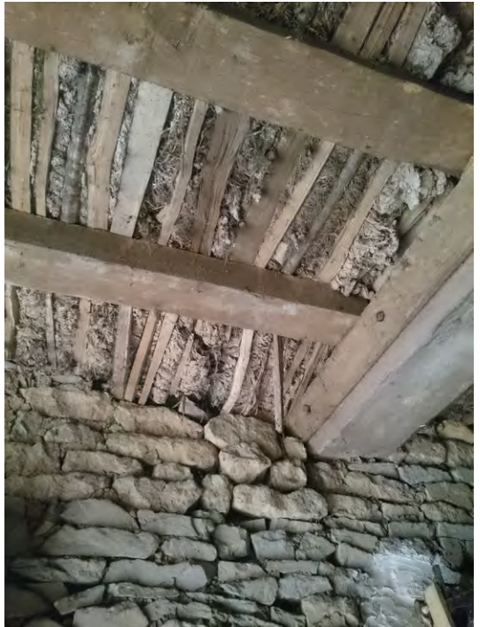
Figure 27: Terri (plancher, chape de torchis) vu par dessous dans un bâtiment en maçonnerie de pierre sèche dans le Calvados, vallée de l'Orne. Photo Sophie Popot
