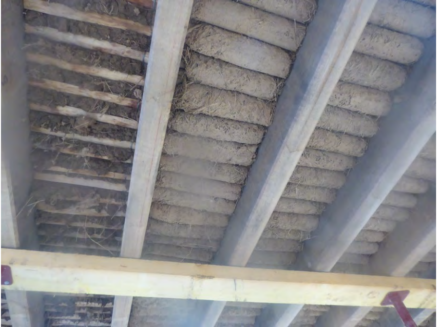
Figure 29: Vu par dessous : Terri fraîchement posé: à gauche chape sur ganivelle / à droite quenouilles préfabriquées. Coutances (50) Chantier Guillaume Charrier / architecte sophie Popot
