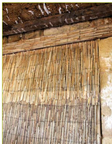
Une canisse a été fixée sur le linteau et le panneau bouchant l'ancienne ouverture. Elle permettra la bonne accroche de l'enduit.
