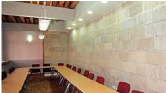
Mur maçonné de blocs de béton de chanvre Crédit photo : HA Segalen
